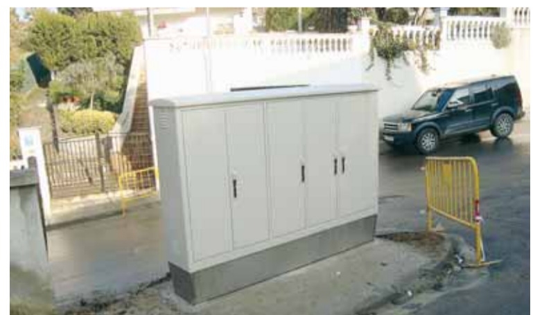
QUADRE DE MANIOBRES NOU
