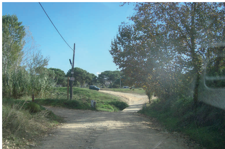
Estat del carrer del Tenes abans de les obres
