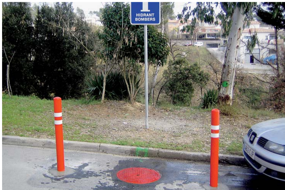
HIDRANT O BOCA D'INCENDI
