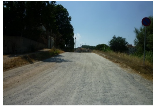
Imatge 22. Pujada abans del canvi de rasant. Manca espai protegit per al vianant.
