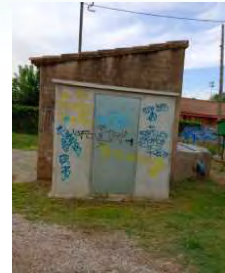
Pou Piscines, sala de cloració.
