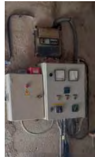
Armaris elèctrics interiors a desmuntat
