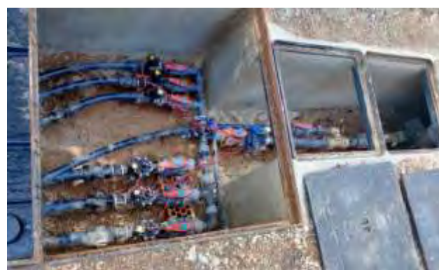
Punt de connexió del reg del Parc de Ca l'Artigues 1.
