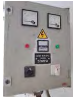
Armari de control del bombament 2
