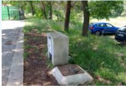
Hidrant càrrega del pou de Palaudàries.
