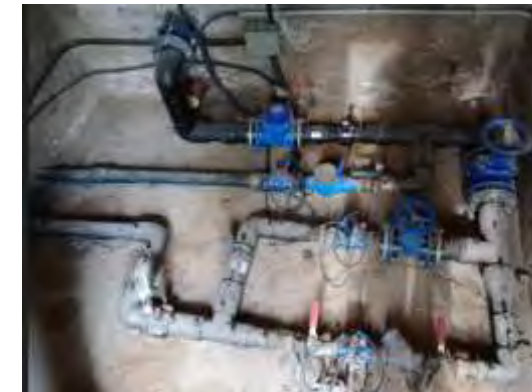
Pou Piscines, interior de la caseta del pou.
