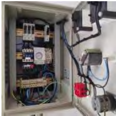
Armari de control del bombament 1
