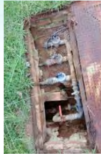
Piscina municipal. Arqueta de control de reg.
