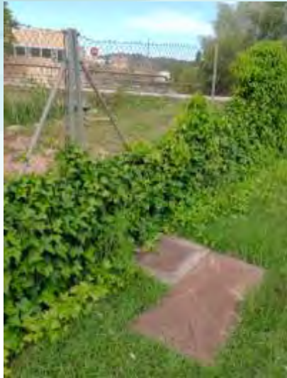
Piscina municipal. Arqueta d'escomesa i de control de reg 1.
