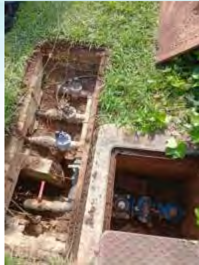
Piscina municipal. Arqueta d'escomesa i de control de reg 2.
