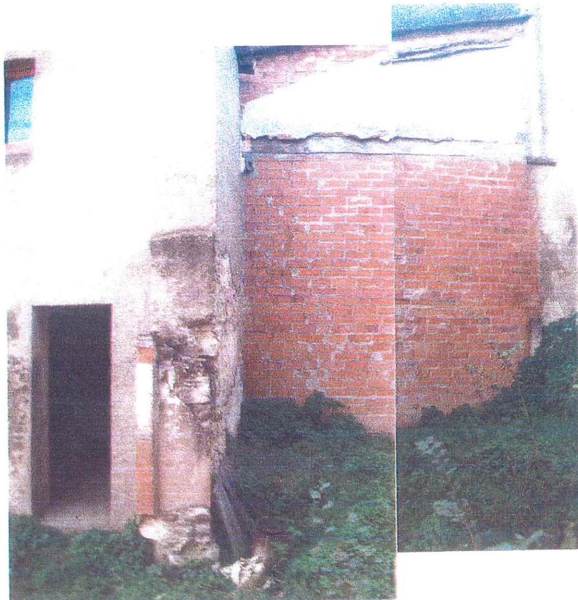
FOTO 11 Can Passarell des del exterior. A la dreta de la porta d'accés es veu una part de la paret enrunada. A la paret del fons es veu la silueta de la coberta del edifici anterior. A baix a la dreta es veu la fita, límit de la propietat, on acabava la vivenda.
