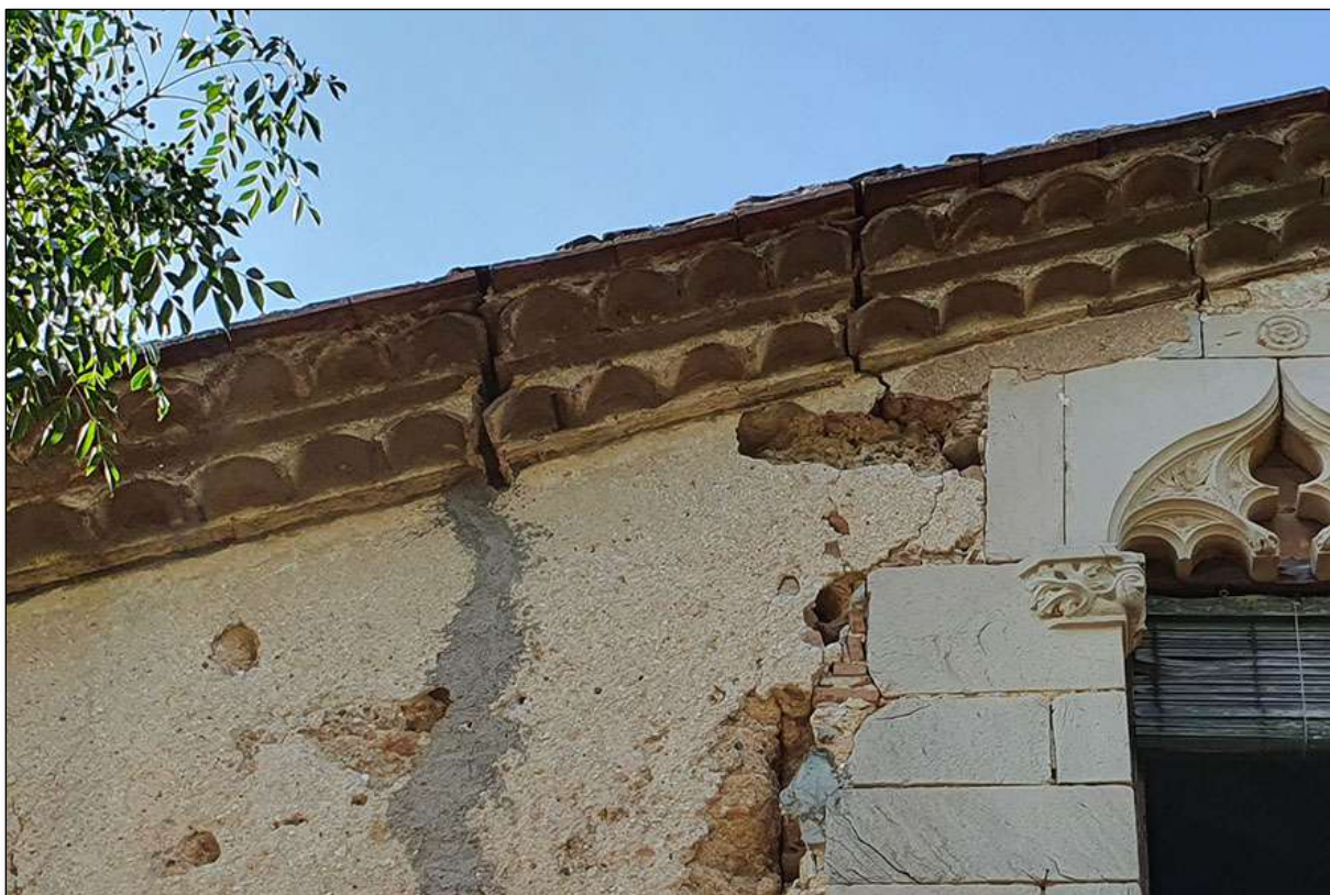
Imatge 181. Ràfec format per doble volada composta per doble rajol i doble teula capell. Ubicació: Façana principal
