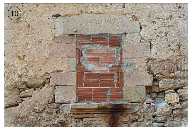
Finestra tapiada realitzada amb llinda plana i brancals de pedra calcària. A la llinda hi ha gravat l'any de creació 1668 i un traç en forma de llaç. La finestra estava dotada d'una reixa, segurament de forja. Així ho indica els suports que hi ha sota la llinda i la taca d'òxid que hi ha sobre el coronament de pedra calcària de l'ampit.
