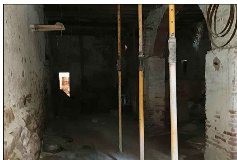
Vista general del celler. A la dreta, una de les dues arcades de mig punt existents.
