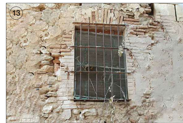
Finestra ubicada a la zona de la cuina, realitzada amb arc a nivell adintelat i muntants de maó massís. La finestra té una reixa de forja amb travessers de passamà i muntants de tub rodó massís.
