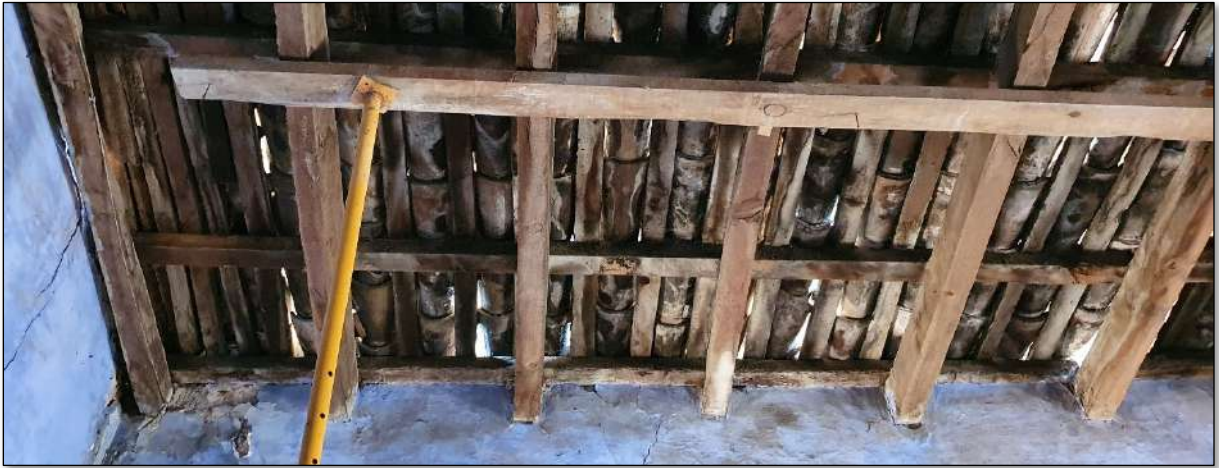
Imatge 153. Tècnica de "llata per canal" sobre corretges i bigues de fusta (cavalls). Ubicació: Sala principal.
