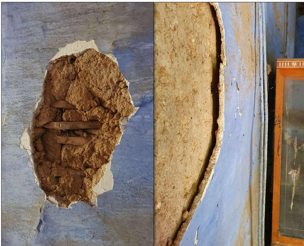
Imatge 121. A l'esquerra vista de l'entramat de llistons de fusta dins la tàpia. A la dreta el revestiment de morter de calç després deixant el mur a exposició dels agents geològics.
