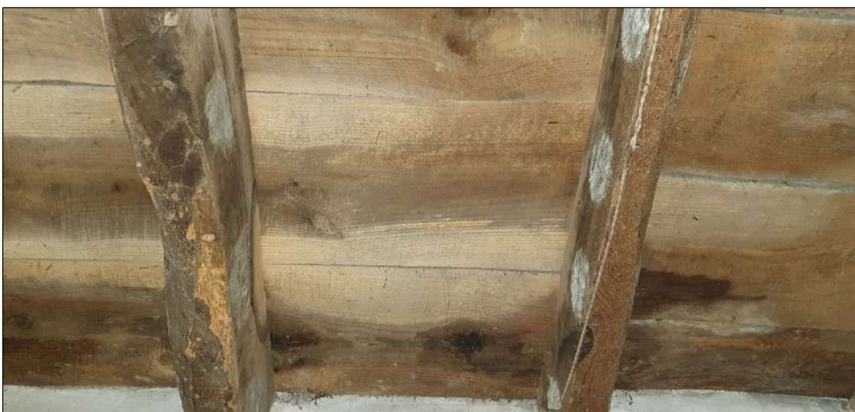
Imatge 135. Forjat horitzontal de bigues de fusta amb tauler de fusta de l'habitació 6.
