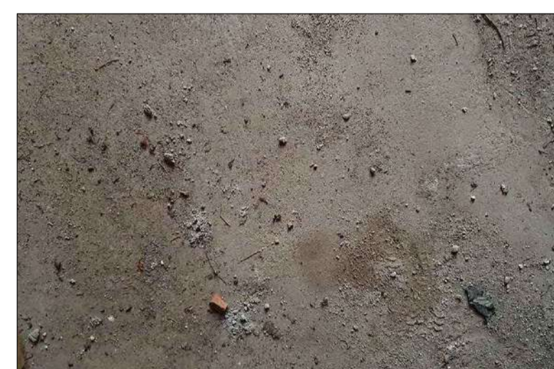
Paviment de formigó acabat llis. Hi ha zones que hi ha terra adherida, possiblement d'acumulació.
