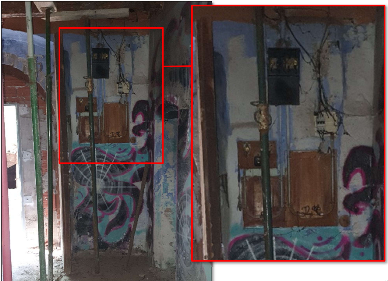
Imatge 229. Ubicació on s'allotjava el quadre de comandaments i els elements de seguretat (ploms) de la masia.
