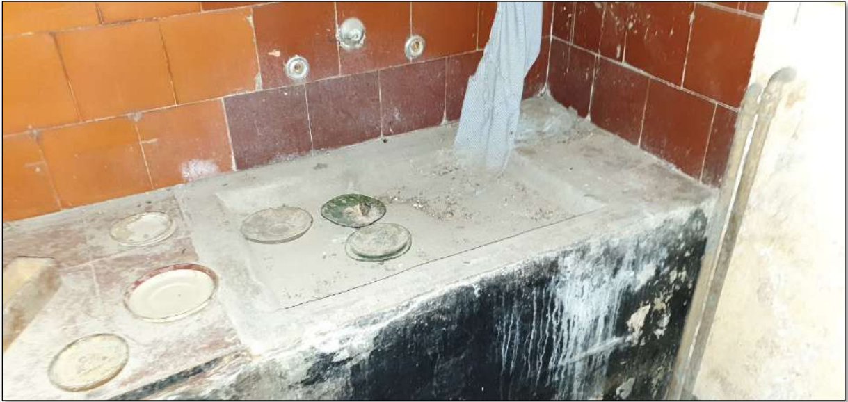
Imatge 240. Manca d'aixeta a la pica de la cuina
