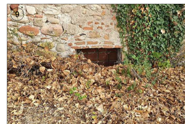
Finestra tapiada pràcticament totalment tapada per les terres exteriors. Aquesta finestra dona al celler i disposa d'una reixa metàl·lica de tub rodó massís.
