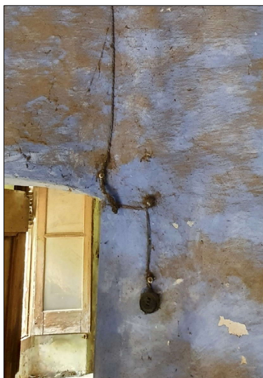
Imatge 232. Interruptor superficial amb cablejat vist.
