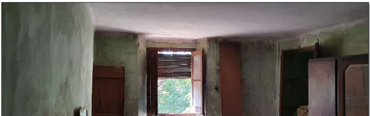
Imatge 147. Cel ras amb encanyissat. Ubicació: Habitació 3
