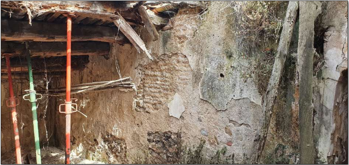
Imatge 123. Mur de separació entre de la cambra calenta i el magatzem del graner. Revestiment després deixant veure les tapiades del mur de tàpia.
