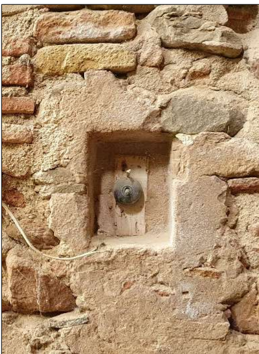
Imatge 233. Interruptor exterior dins de fornícula col·locat sobre tac de fusta. Ubicació: Garatge-safareig.
