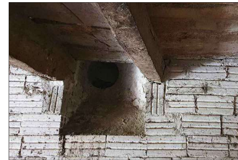
Tub de ventilació que va del magatzem fins a teulada, passant pel celler.
