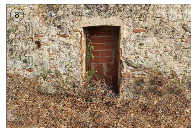
Porta tapiada que es troba mig tapada per les terres exteriors. Aquesta porta dona a unes escales de fusta que donen pas al celler.
