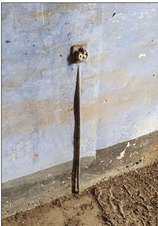
Imatge 231. Endoll superficial amb cablejat embeinat.
