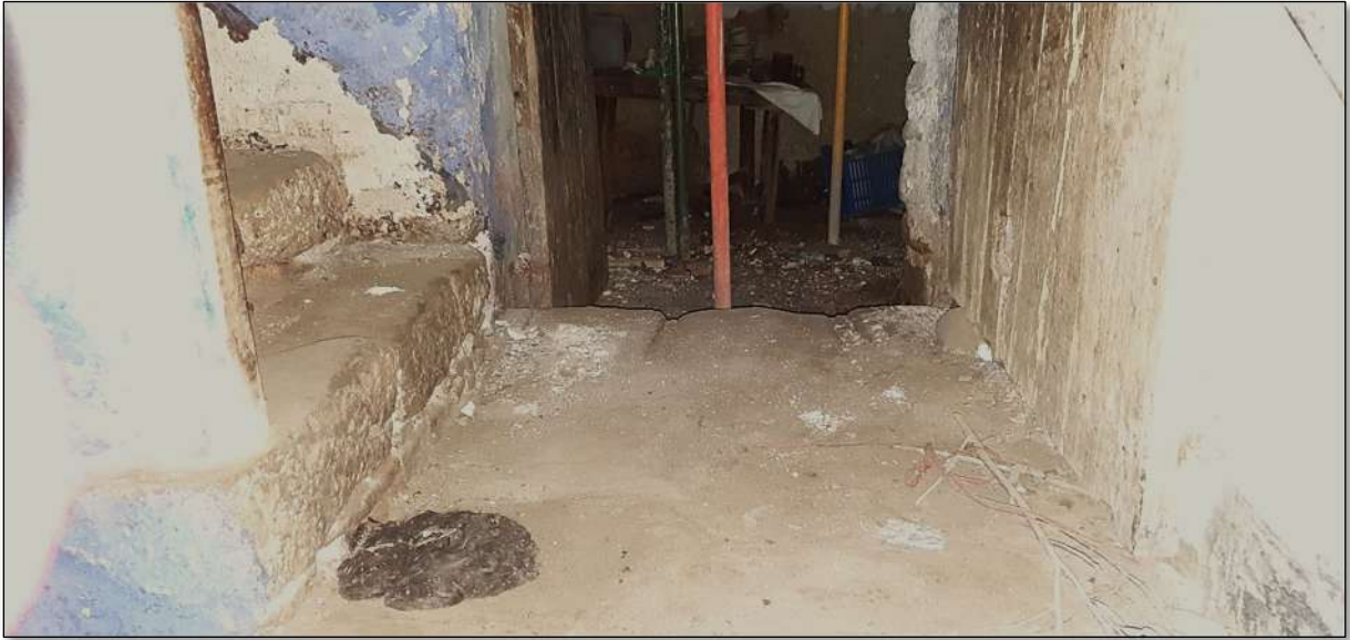
Imatge 172. Replà intermedi d'escala. Al front el rebost, a l'esquerra el segon tram d'escala.
