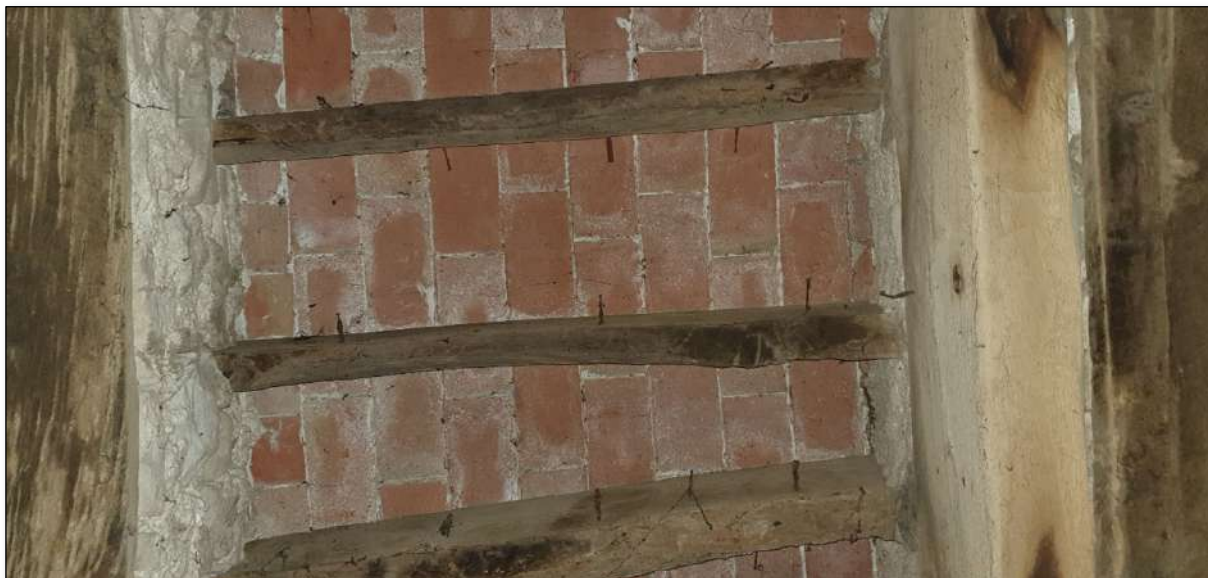
Imatge 138. Forjat de bigues de fusta de secció variable rectangular amb tauler ceràmic. Ubicació: Pas cap al celler.
