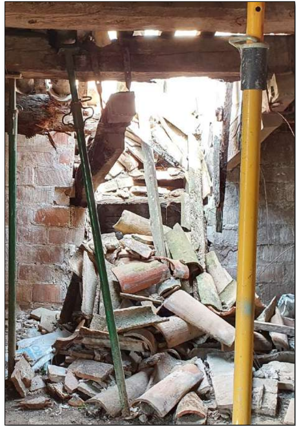
Imatge 179. Escala de dos muntants de fusta ubicada en el graner. Està tapada i mig enderrocada per la runa.
