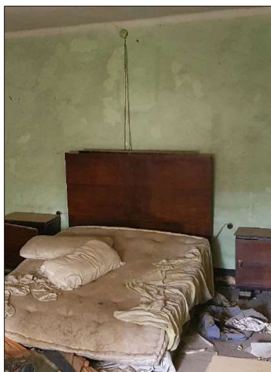
Imatge 234. Instal·lació vista cap endolls de les tauletes de nit. Ubicació: Dormitori 3
