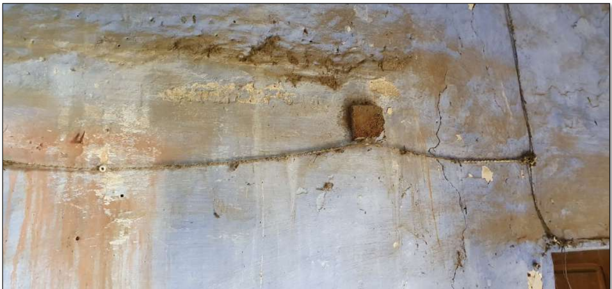
Imatge 230. Instal·lació de cable trenat vist i caixa superficial de derivació al mur. Ubicació: Sala principal planta primera.
