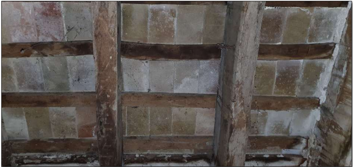
Imatge 142. Forjat de bigues de fusta rectangulars de secció variable i tauler de rajol massís de terra cuita de 15x30cms, a junt seguit, col·locat sobre llates de fusta. Ubicació: Rebost.
