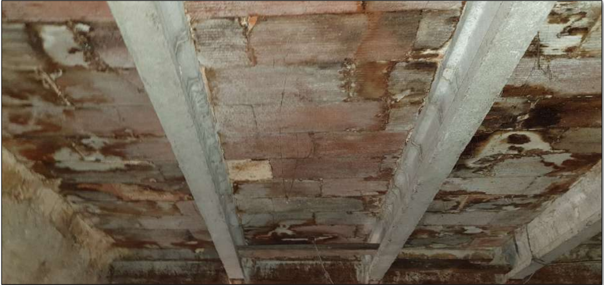
Imatge 144. Forjat de bigues autorresistents de formigó i 20cms d'alçada amb tauler recolzat de maó ceràmic buit 40x20cms a trencajunts. Ubicació: Cort.
