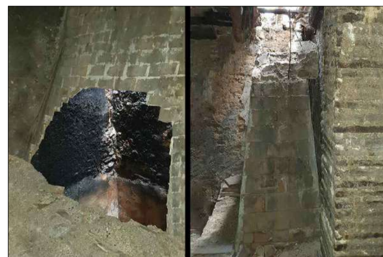
A l'esquerra, la campana de la llar de foc del menjador mig enderrocada. A la dreta, la campana del forn que hi ha a l'obrador.
