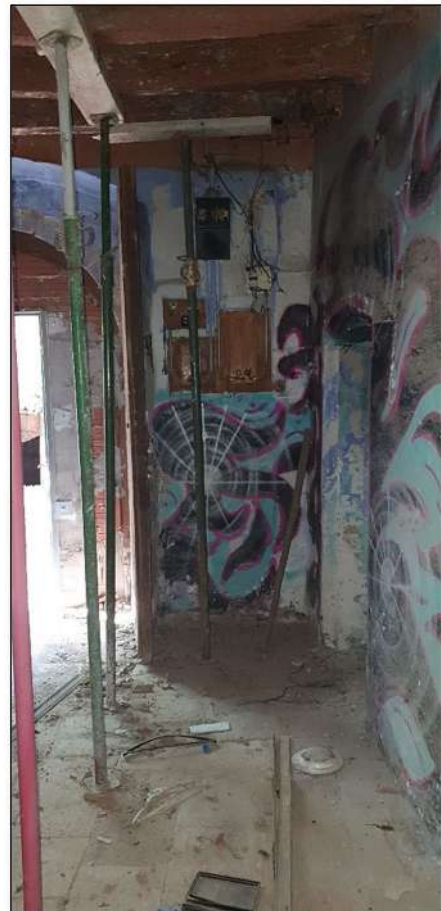
Imatge 17. Ubicació quadre elèctric.
