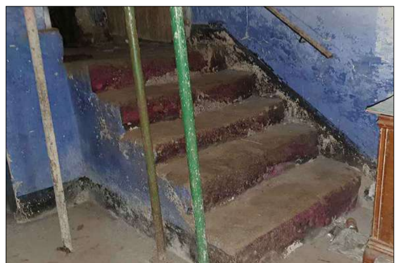
Arrencada massissa d'escala de tretze graons amb dos trams a escaire i esglaonat recte de pedra.
