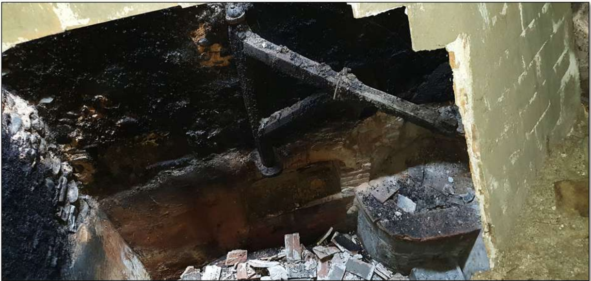
Imatge 98. Vista de la llar de foc des de la campana enderrocada. Al centre tornapunts giratori a la dreta en cendrer.
