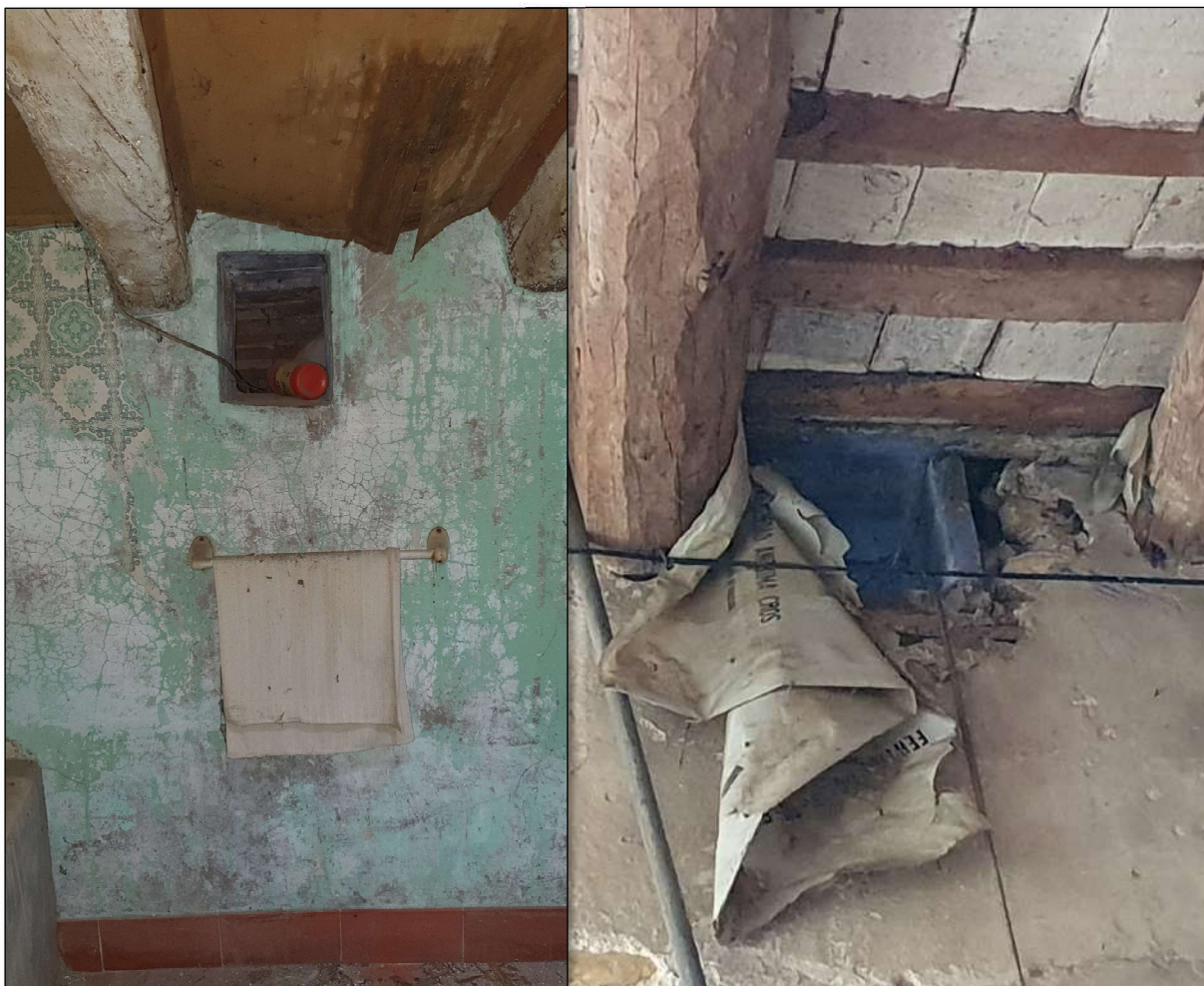
Imatge 81. A l'esquerra, obertura per a ventilació vista des del bany. A la dreta l'obertura vista des del garatge-safareig.
