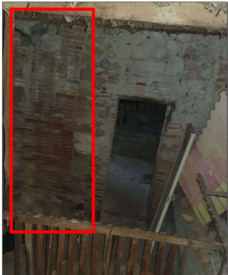
Imatge 127. A l'esquerra mur de maó que coincideix amb el bany de la planta primera.
