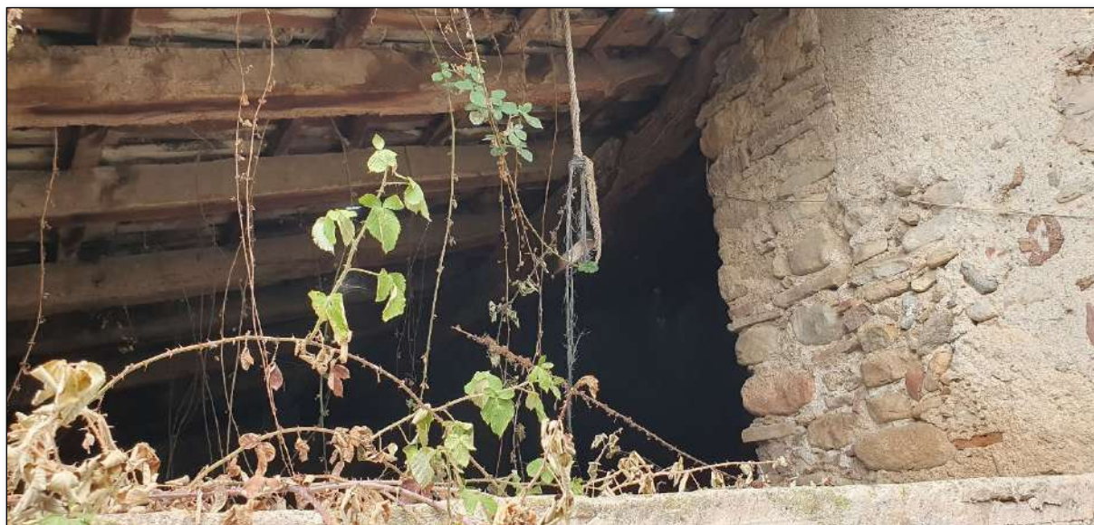
Imatge 152. Vista general de la coberta inclinada de la zona de dipòsits.
