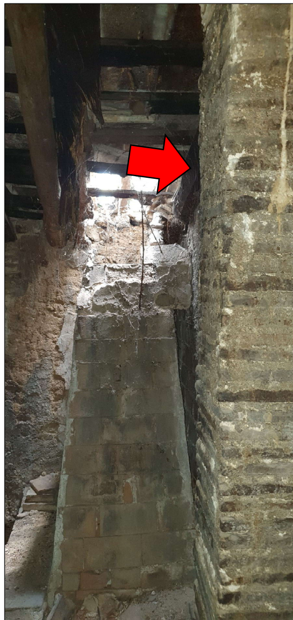
Imatge 129. Pilar de maó massís per a suport de reforç de fusta per a reducció de llum de sostre.
