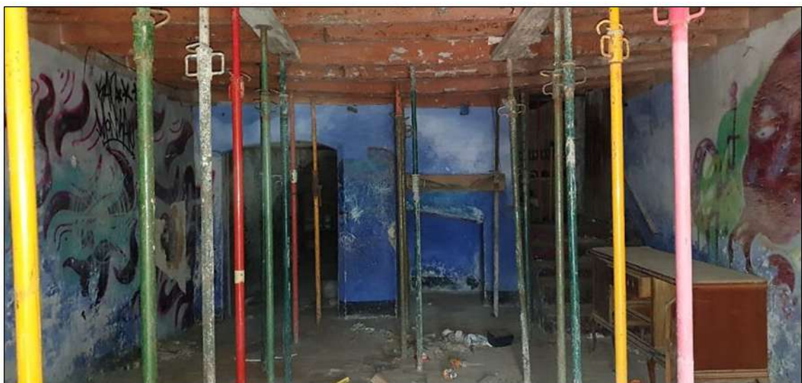
Imatge 20. Vista general sala principal. Dreta escales cap a planta primera. Esquerra pas cap al celler.
