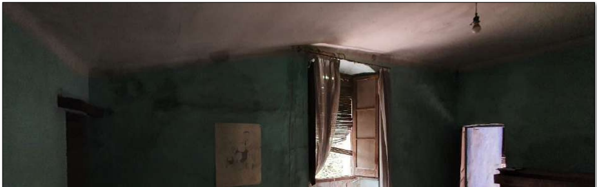
Imatge 146. Cel ras amb encanyissat. Ubicació: Habitació 1
