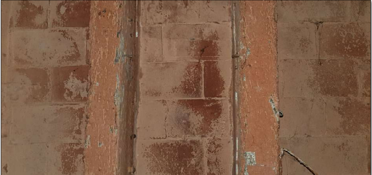
Imatge 136. Forjat horitzontal de bigues de fusta amb tauler ceràmic bigues de fusta de secció rectangular variable i tauler de rajola massissa manual de 15x30cms de terra cuita col·locada a trencajunts. Ubicació: Sala principal.
