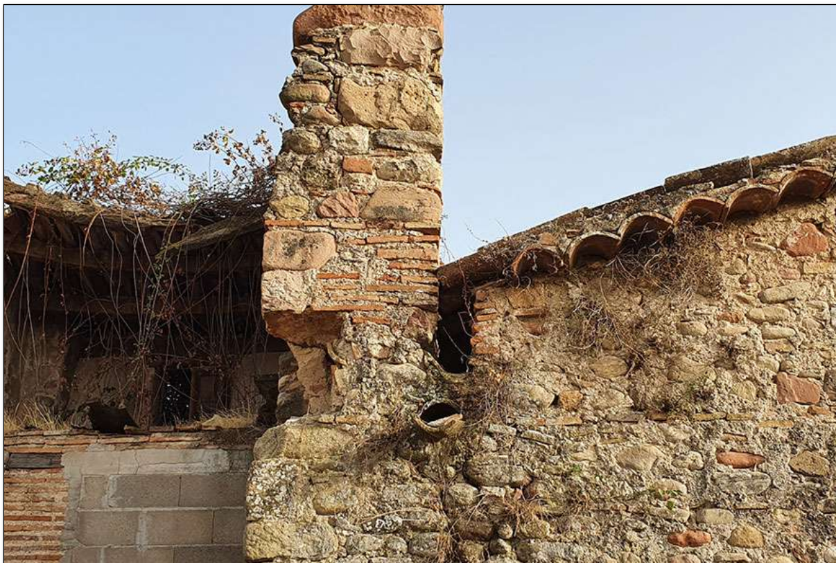
Imatge 187. Formació d'aiguafons en trobada de coberta amb parament vertical. La gàrgola és una teula aràbiga en posició canal, la capell està trencada.
