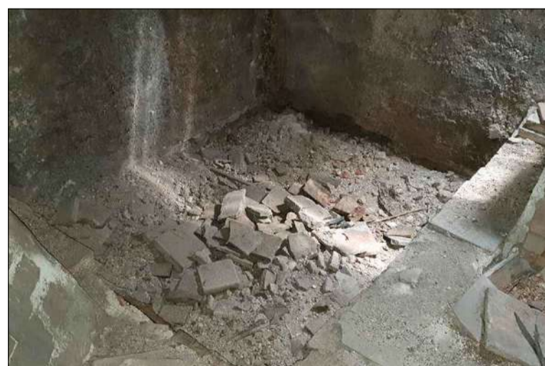
Sostre del forn existent a l'obrador. Feia la funció d'emetre l'escalfor de la cúpula del forn cap a la cambra. A part d'escalfar la masia, també s'utilitzava de zona per assecat la roba rentada.
