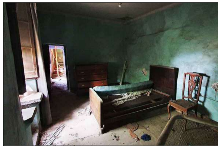
Vista general de l'habitació 1. Al fons la porta d'accés a l'habitació. A l'esquerra, la finestra amb festejador. A diferència de les altres estances el sostre és un cel ras realitzat amb la tècnica d'encanyissat.
