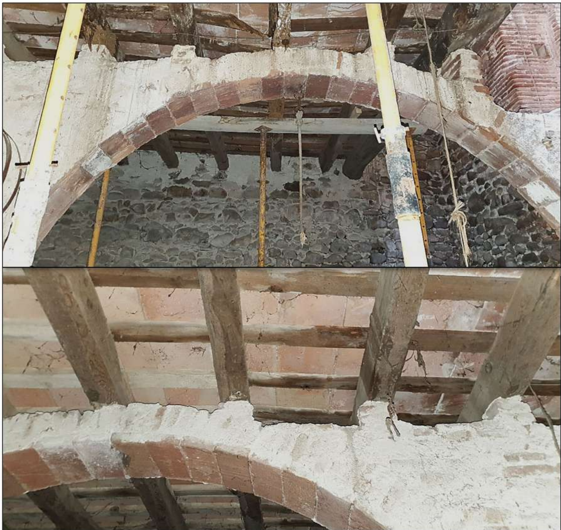
Imatge 30. A dalt, vista general de l'arc de mig punt. A sota, detall de resolució dels suports per a les bigues passants.
